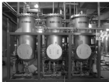
排水処理装置
