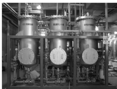
排水処理装置
